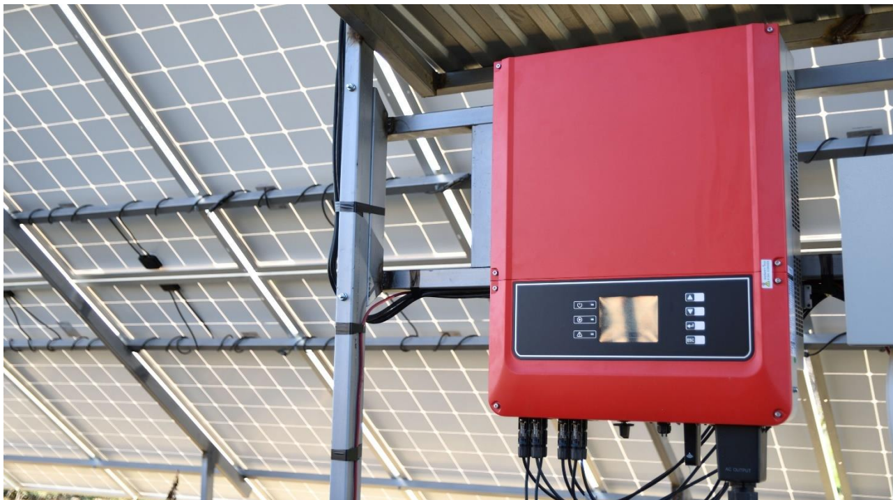
Zdjęcie 3 Przykładowy inwerter farmy fotowoltaicznej. Źródło: https://pvtec.pl/jak-prawidlowo-dobrac-inwerter-do-instalacji-fotowoltaicznej/
