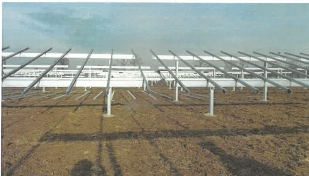
Fot. 2 Konstrukcja stalowa stelaży pod moduły fotowoltaiczne
