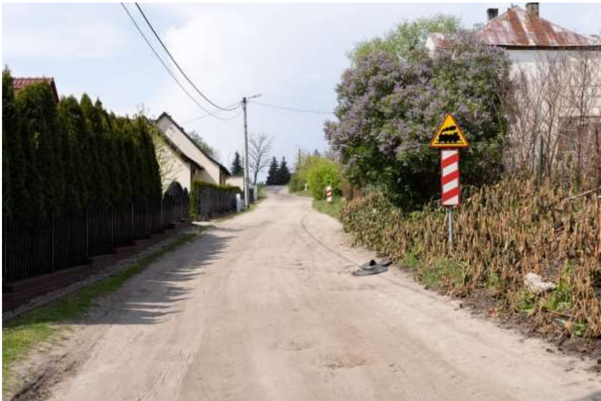
Rysunek 13. Stan techniczny drogi- osiedle Kasprowicza
