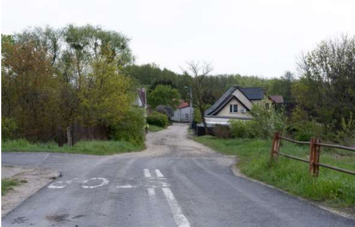
Rysunek 14. Stan techniczny drogi- osiedle Kasprowicza
