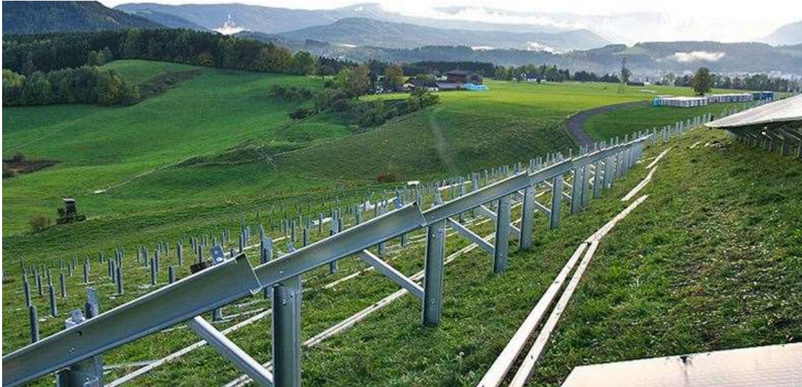
Zdjęcie 6 Konstrukcja przeznaczona do posadowienia paneli fotowoltaicznych.
