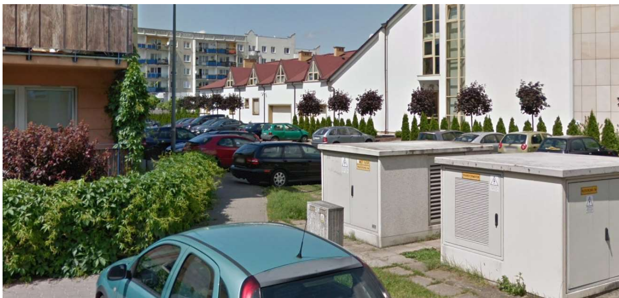
Zdjęcie 8 Standardowe stacje kontenerowe w otoczeniu zabudowy.
