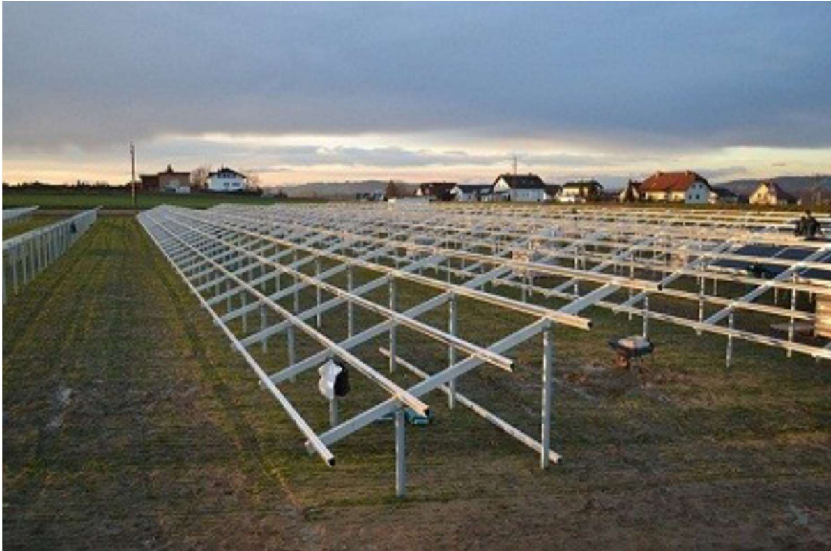
Zdjęcie 12 Szkielety przed montażem paneli, elektrownia solarna NIENBURG 4 MW (Niemcy) (Remor Solar).
