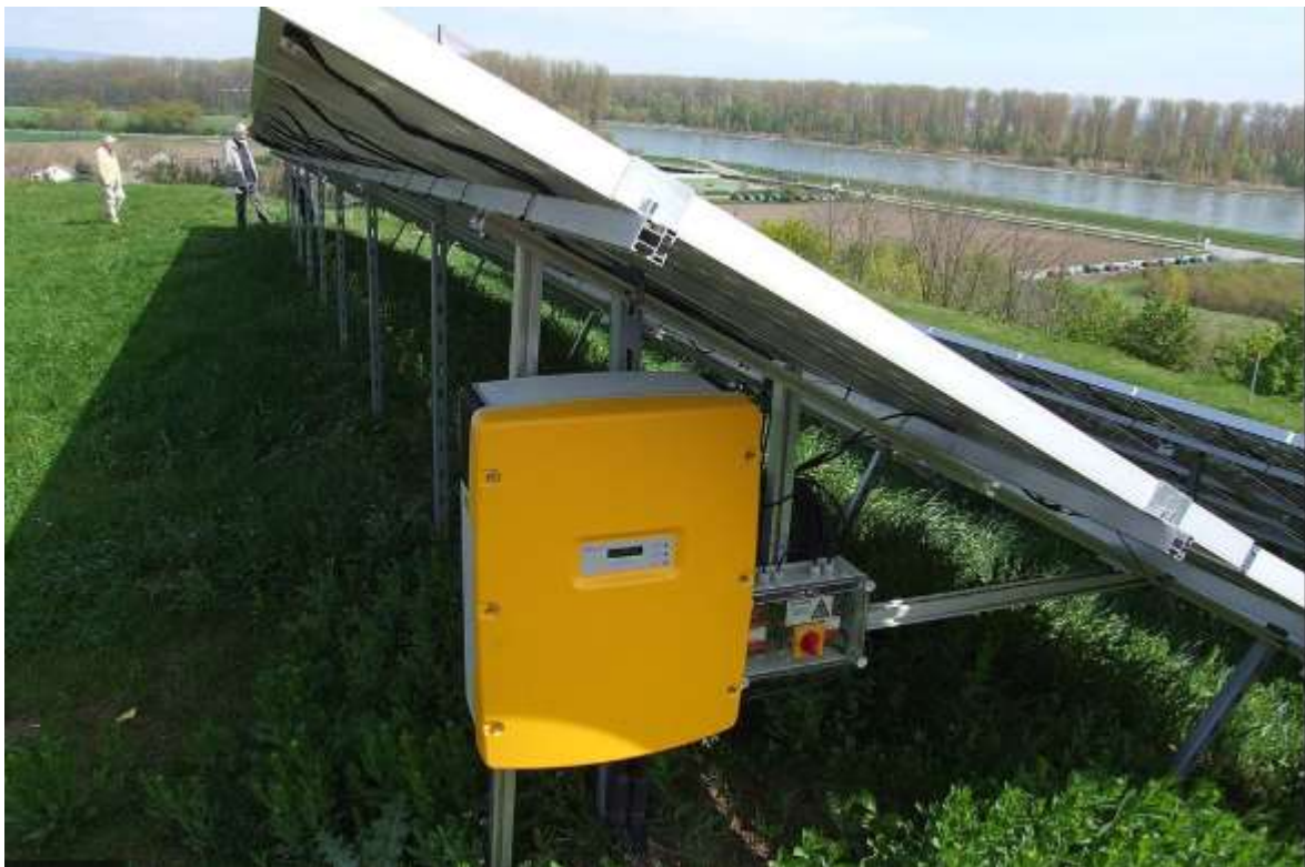
Zdjęcie 7 Przykładowy inwerter elektrowni fotowoltaicznej.
