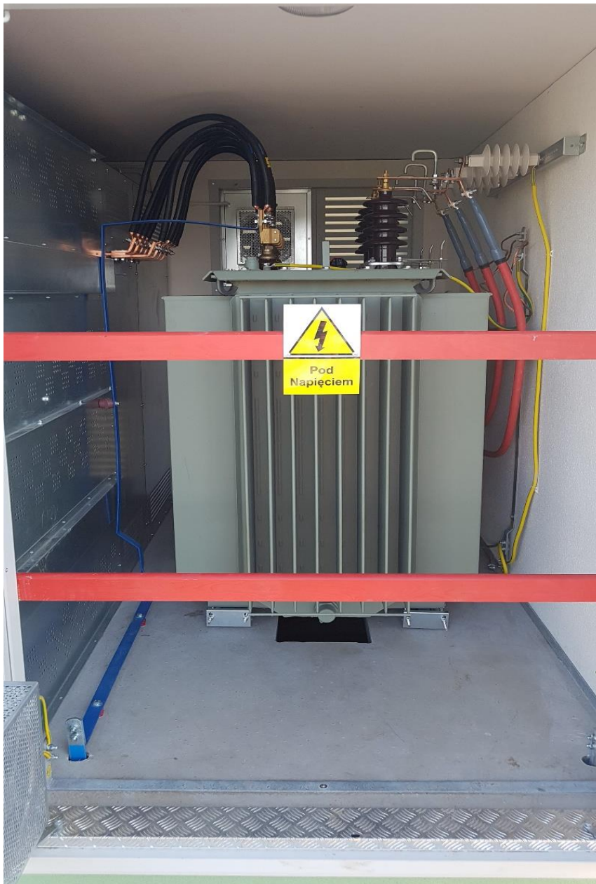
Rysunek 19 Stacja transformatorowa o mocy 0,8 MVA
