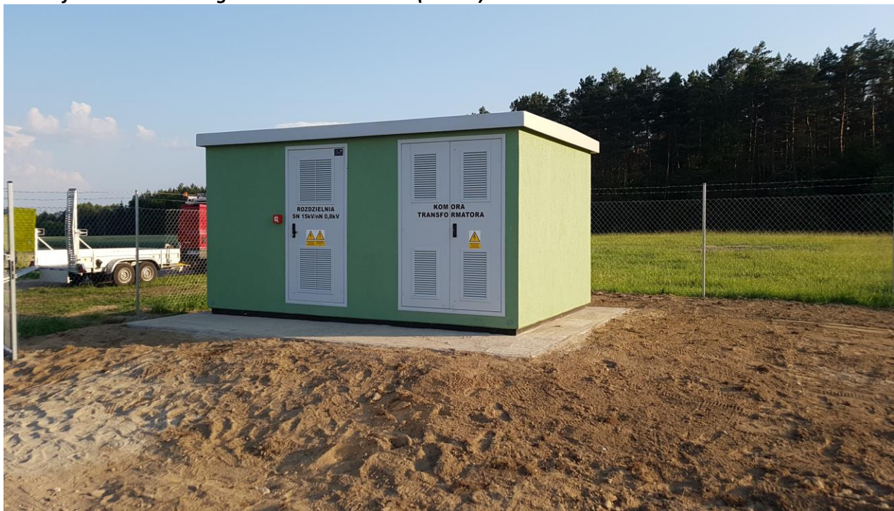
Rysunek 20 Budynek techniczny widziany od strony wejść do rozdzielni i komory transformatora
