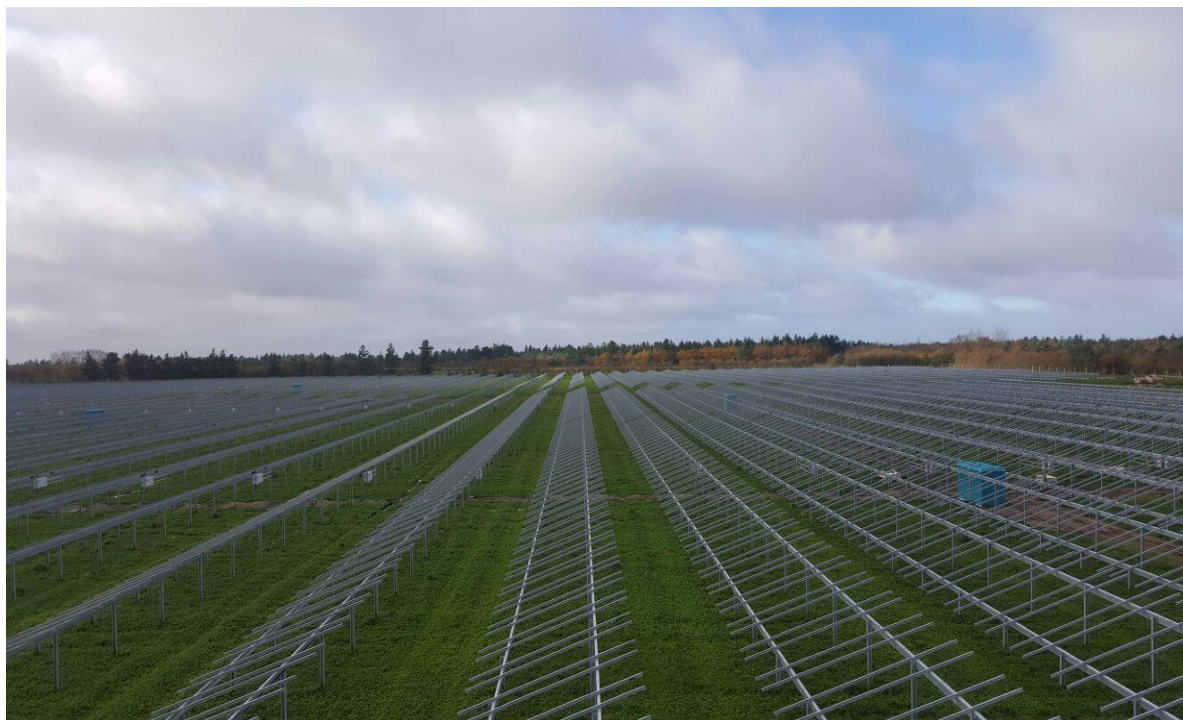
Rysunek 13 Konstrukcja wsporcza oparta na dwóch rzędach profili wbitych bezpośrednio w grunt
