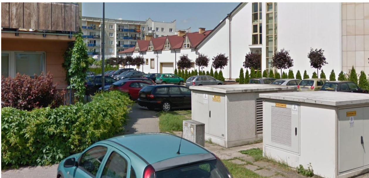
Rycina 9. Standardowa stacja kontenerowa w otoczeniu zabudowy.
