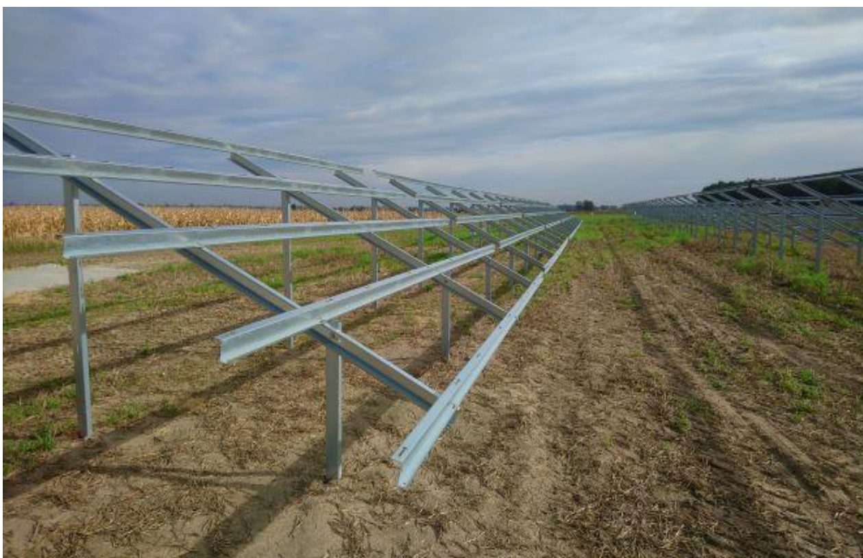
Rysunek 14 Konstrukcja stała przeznaczona do posadowienia paneli fotowoltaicznych.
