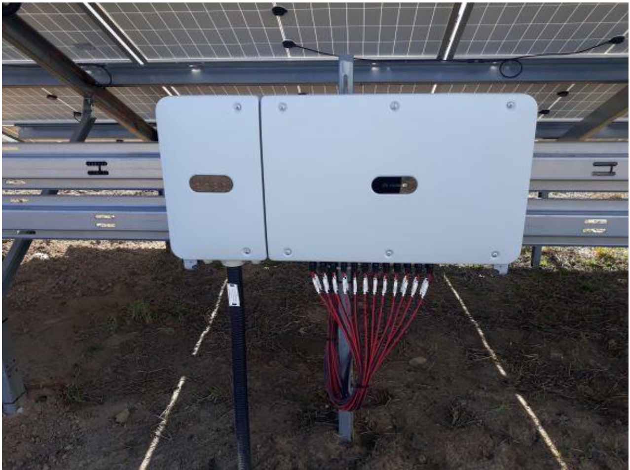
Rycina 7. Przykładowy inwerter farmy fotowoltaicznej.
