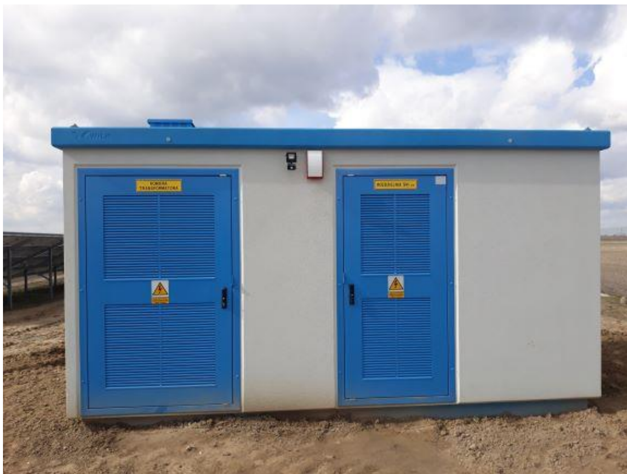
Rycina 8. Przykładowa stacja transformatorowa.
