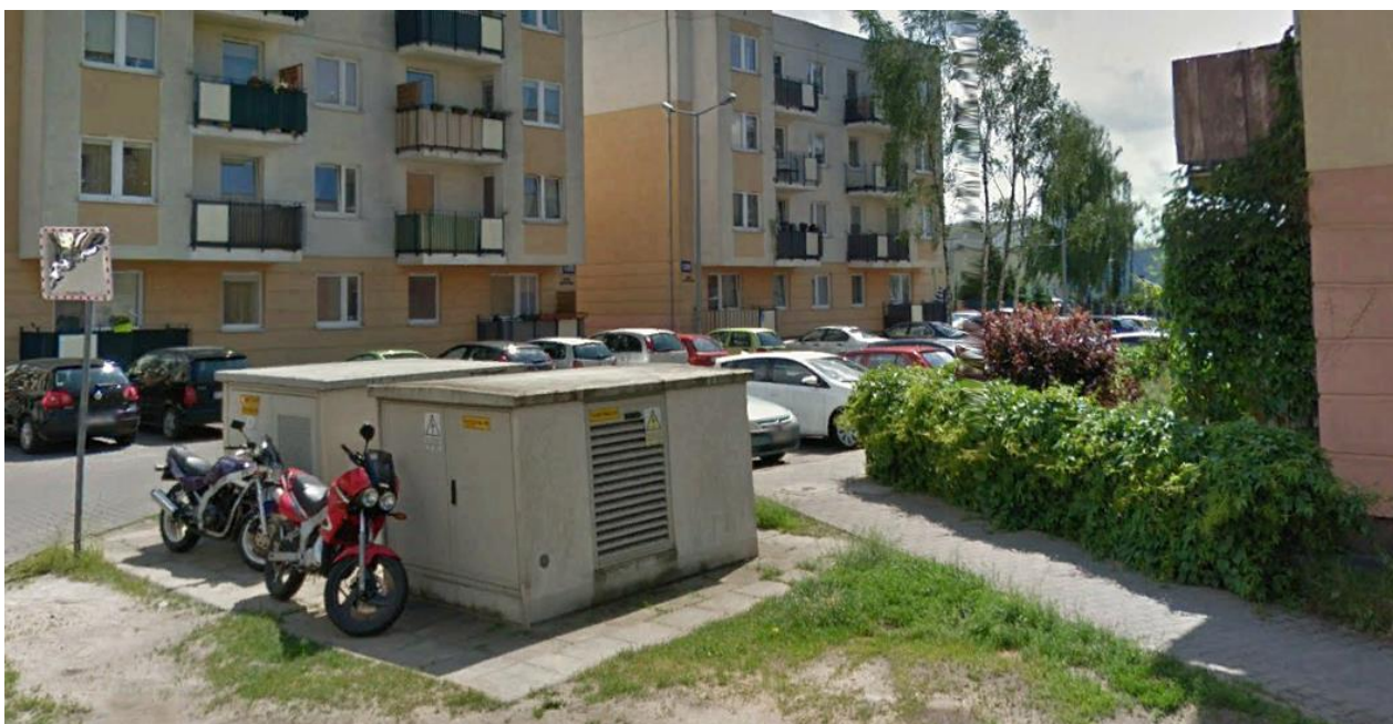
Rycina 10. Stacje transformatorowe w otoczeniu zabudowy mieszkaniowej.
