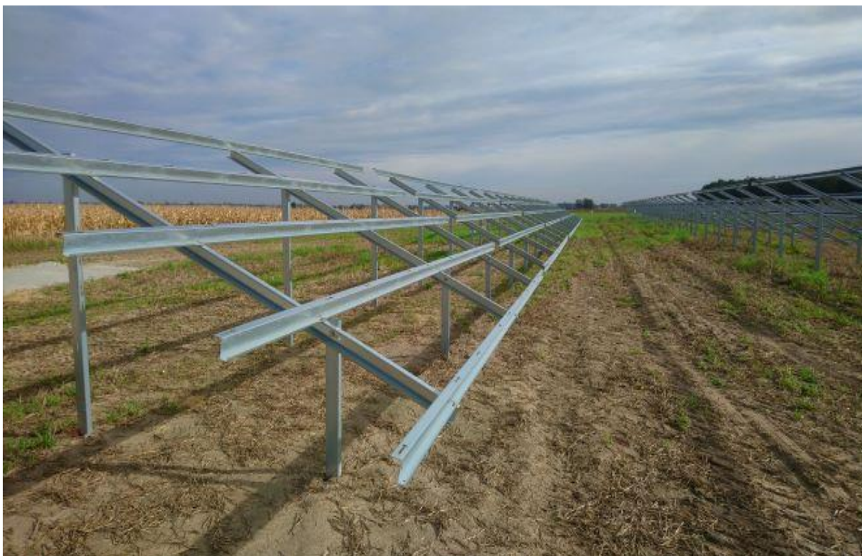
Rysunek 9 Konstrukcja stała przeznaczona do posadowienia paneli fotowoltaicznych.
