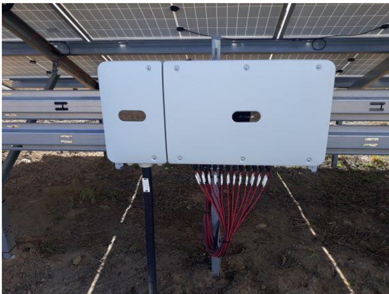
Rycina 7. Przykładowy inwerter farmy fotowoltaicznej.
