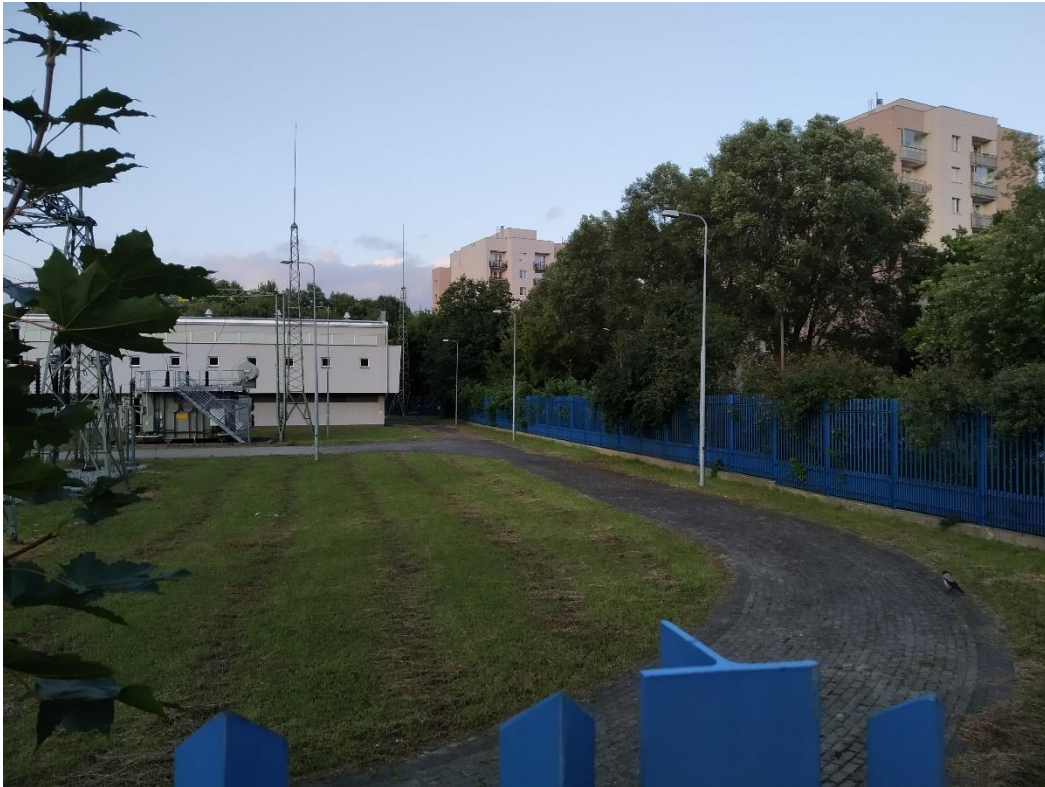
Zdjęcie 6. Stacja 110/SN typu GPZ przy ul. Jana Ciszewskiego w Warszawie w rejonie zabudowy mieszkaniowej wielorodzinnej (źródło: PGE E.O.)
