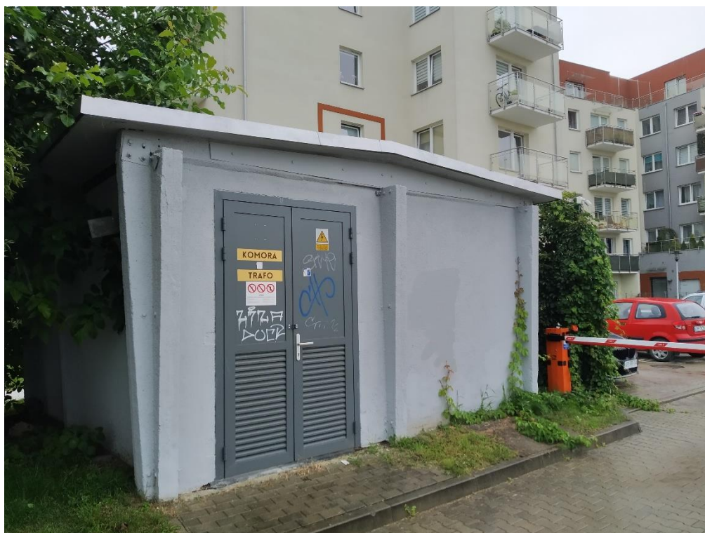
Zdjęcie 8. Stacja elektroenergetyczna nN/SN zlokalizowana w odległości ok. 7 m od budynku mieszkalnego wielorodzinnego (źródło: PGE E.O)
