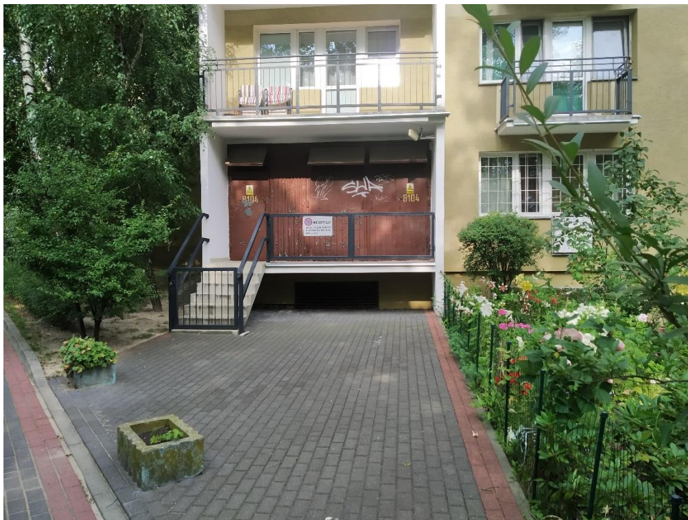
Zdjęcie 7. Stacja elektroenergetyczna nN/SN umieszczona w budynku mieszkalnym wielorodzinnym (źródło: PGE E.O)
