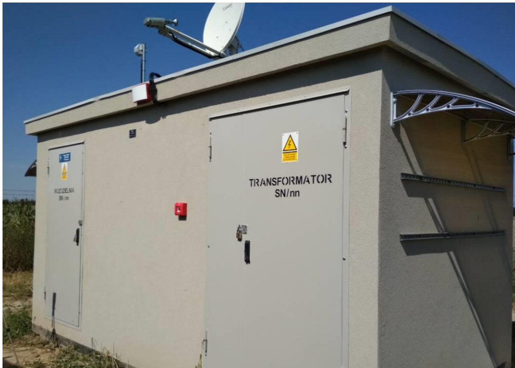
FOTOGRAFIA 5. Przykładowa stacja transformatorowa z urządzeniami sterującymi i monitorującymi, towarzysząca instalacji fotowoltaicznej w miejscowości Olszanka (woj. opolskie) [fot. Paweł Kręciproch]
