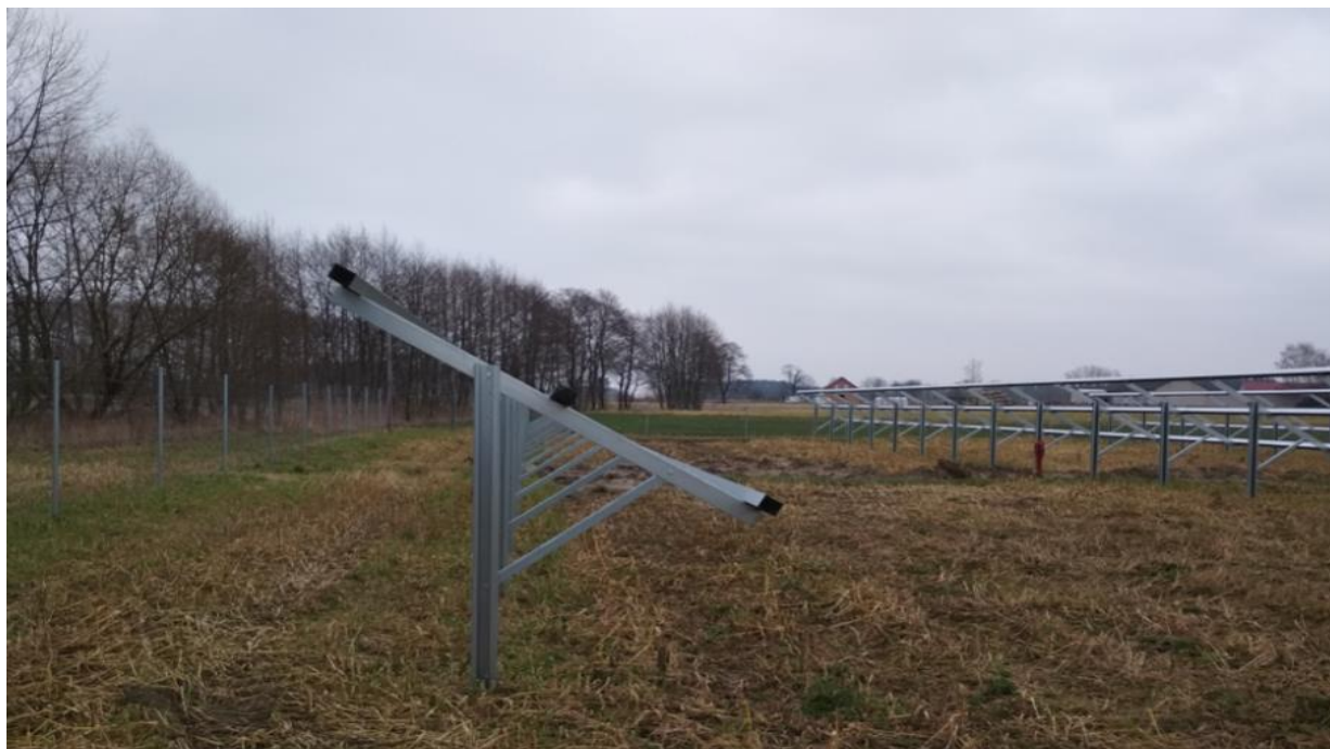
FOTOGRAFIA 3. Przykładowe konstrukcje wsporcze przygotowane do montażu paneli fotowoltaicznych – widoczne kilkumetrowe odstępki między rzędami, [foto: Paweł Kręciproch; instalacja w miejscowości Poddębice]
