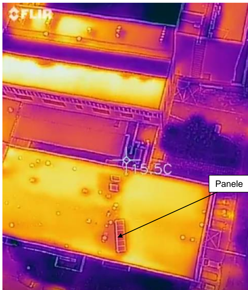
Rysunek 17. Dach budynku z układem paneli fotowoltaicznych – obraz termowizyjny
