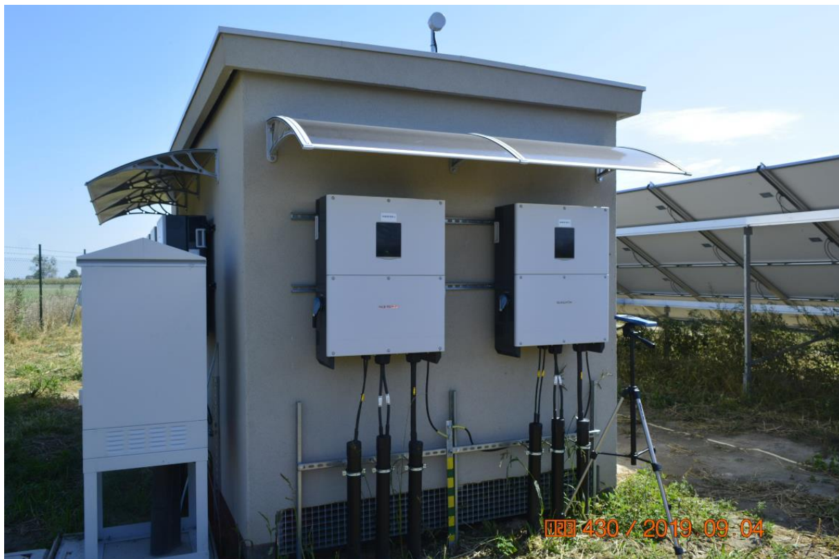
FOTOGRAFIA 8. Budynek stacji transformatorowej z zawieszonymi na ścianie inwerterami na farmie fotowoltaicznej w Krzyżowicach w dniu 4 września 2019 r.
