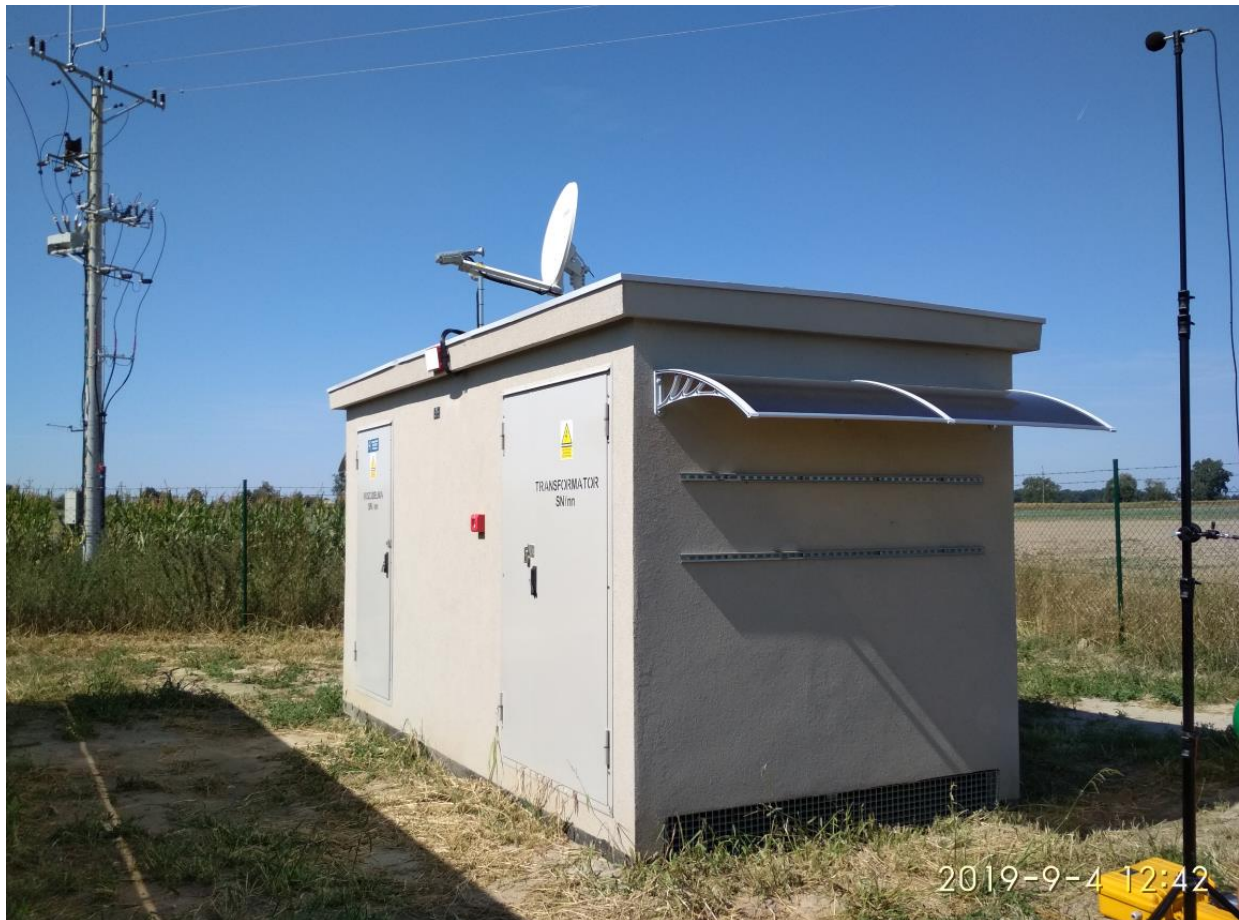
FOTOGRAFIA 9. Ten sam budynek stacji transformatorowej z drugiej strony podczas badań akustycznych na farmie fotowoltaicznej w Krzyżowicach w dniu 4 września 2019 r. [foto: Krzysztof Kręciproch]
