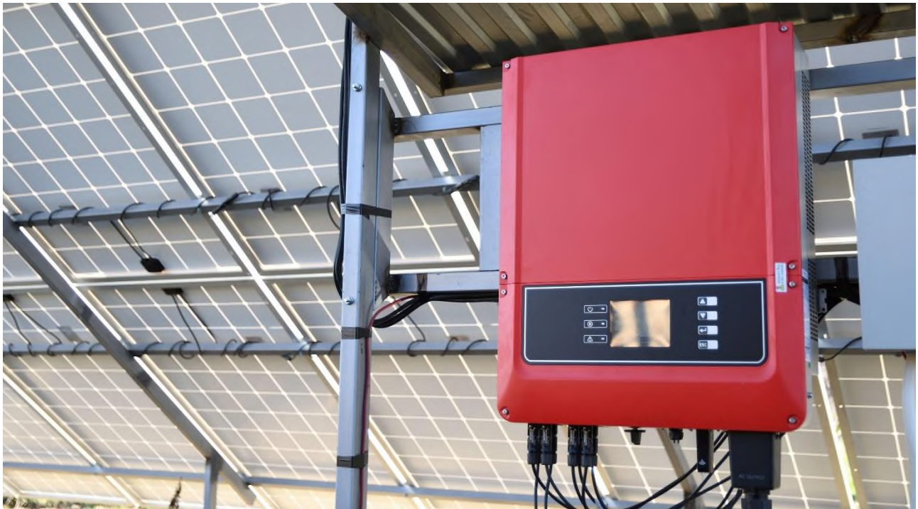
Zdjęcie 3 Przykładowy inwerter farmy fotowoltaicznej. Źródło: https://pvtec.pl/jak-prawidlowo-dobrac-inwerter-do-instalacji-fotowoltaicznej/
