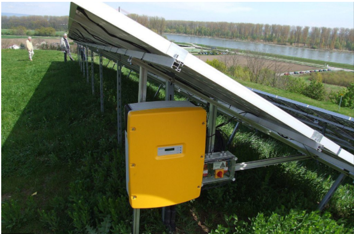
Zdjęcie 4 Przykładowy inwerter farmy fotowoltaicznej.
