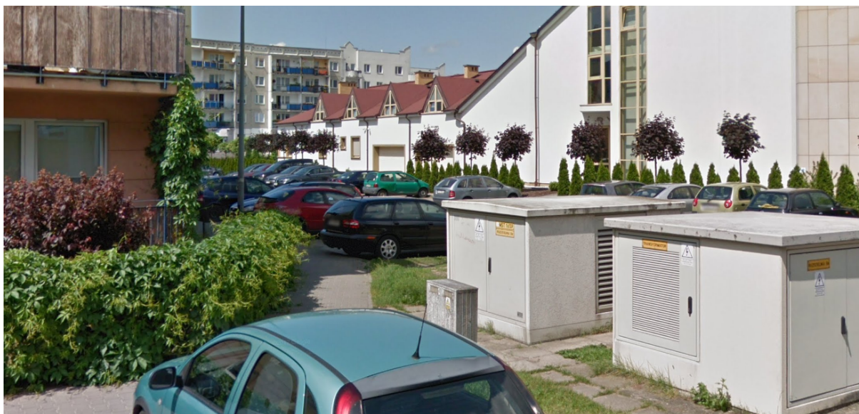
Zdjęcie 5 Standardowe stacje kontenerowe w otoczeniu zabudowy.
