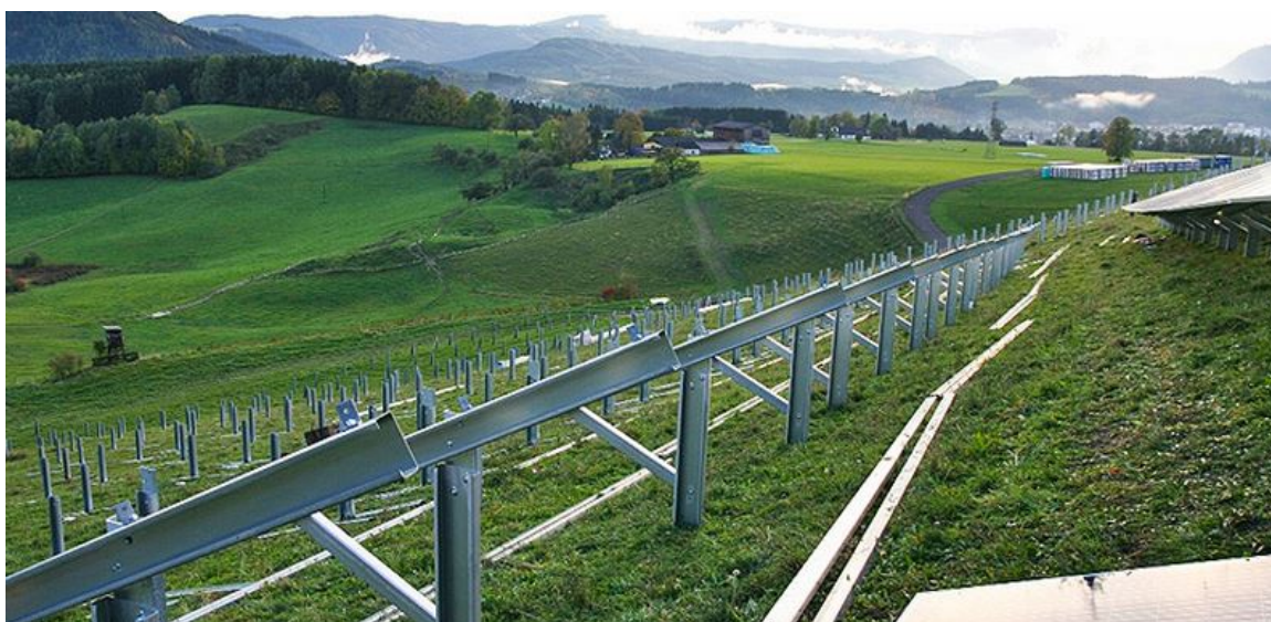
Zdjęcie 3 Konstrukcja przeznaczona do posadowienia paneli fotowoltaicznych.
